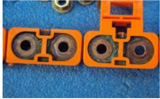
Figura 9. Presencia de Oxido
